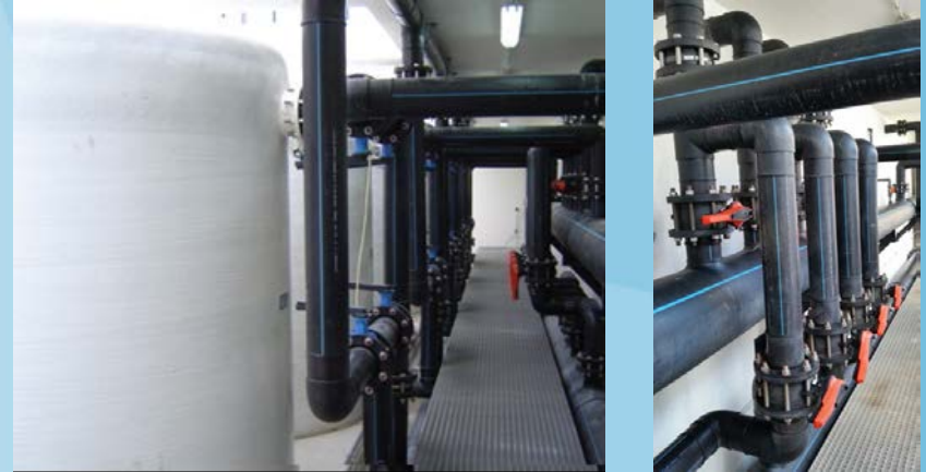
Figura 2. Re-mineralización mediante lechos de calcita y sistema de by-pass.
